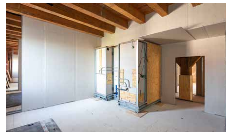
Alleen de leidingen hoefden te worden aangesloten. (Beeld: cepezed | Lucas van der Wee)
